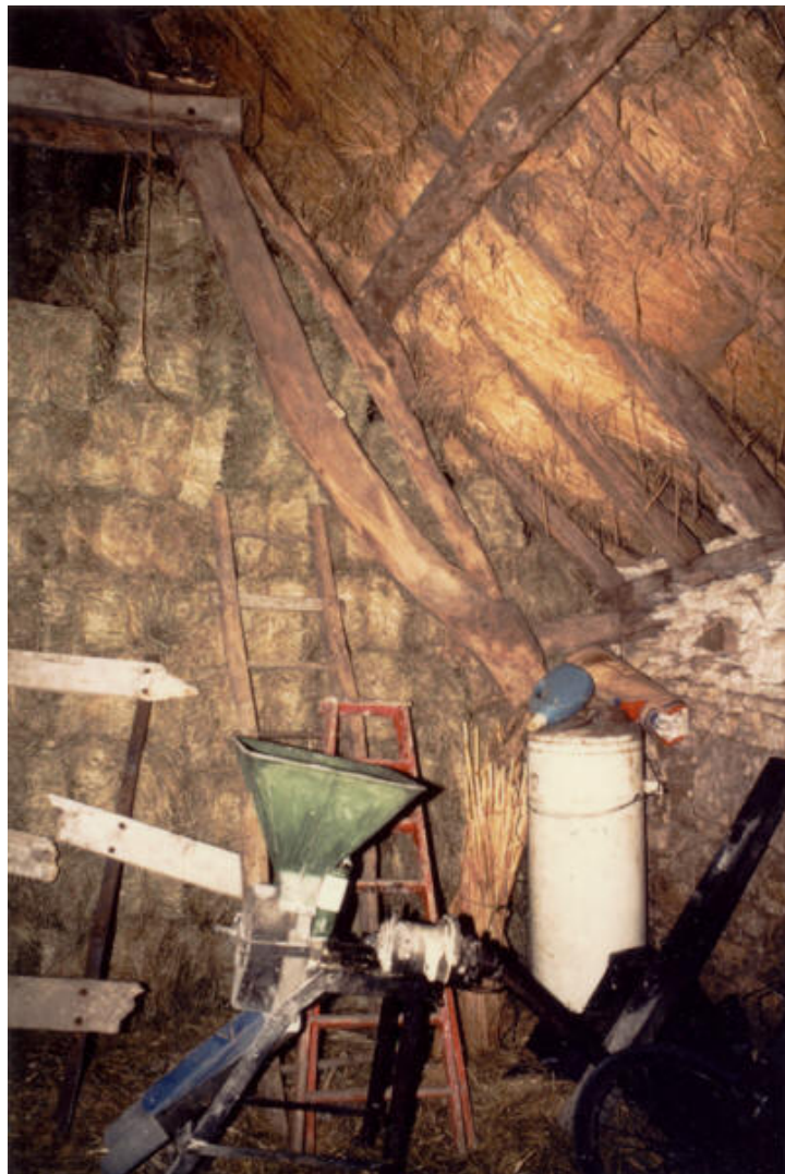
L'arbalétrier de droite en F2 : il pose au sol mais un blochet l'ancree dans la maçonnerie du gouttereau
