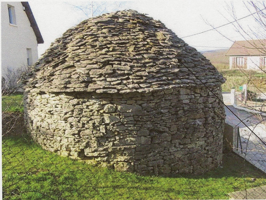
Fissure sur la couverture
