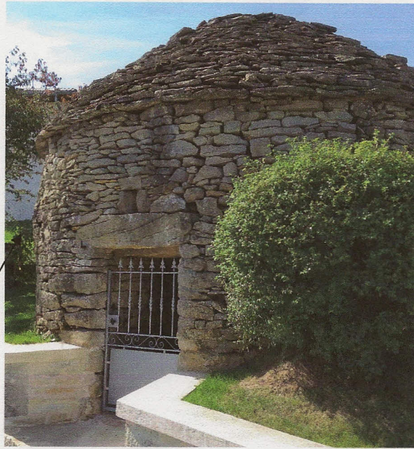
Mur qui « bombe, juste sous le niveau de la fissure »
